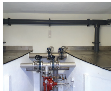
Le réservoir de Villard Montet et ses deux cuves
